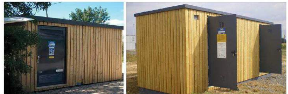
Photo 142 : Exemple de poste de livraison
