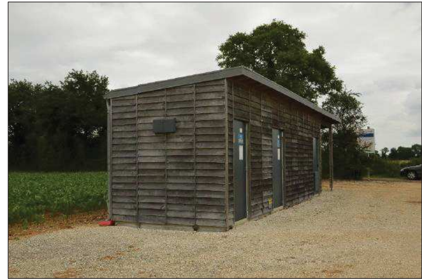
Photo 145 : Exemple de bardage-bois sur un poste de livraison
